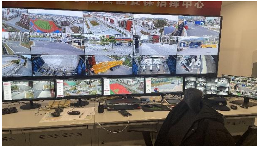
图 3-6 校园监控中心
